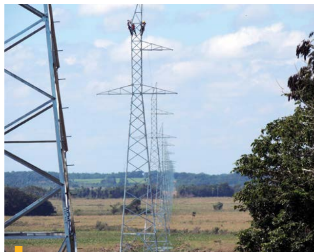
Torres de transmisión 220 KV | Santaní
