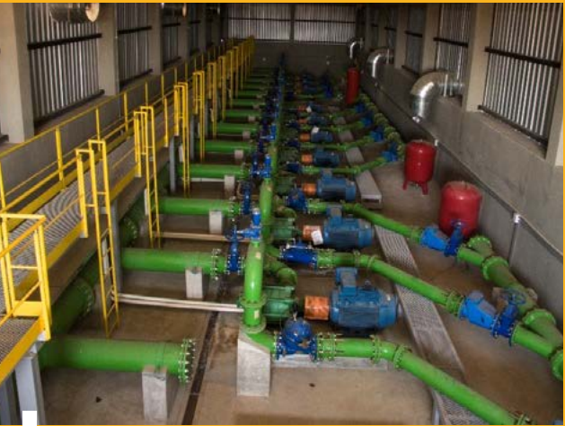
Estación Central de bombeo | Loma Plata
